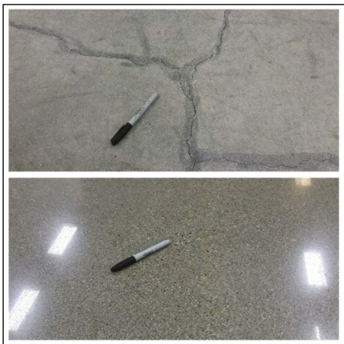
Fig. 1: Una grieta reparada correctamente, será difícil de ver una vez terminado un adecuado pulido del piso.
