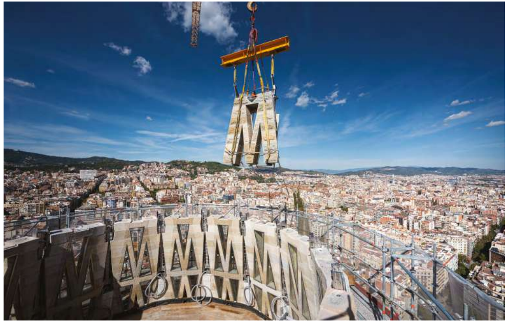
Fig. 7: Construcción de las torres centrales usando paneles de piedra pretensados reforzados mediante columnas de acero inoxidable unidas con concreto de alta resistencia © Fundació Junta Constructora del Temple de la Sagrada Família
