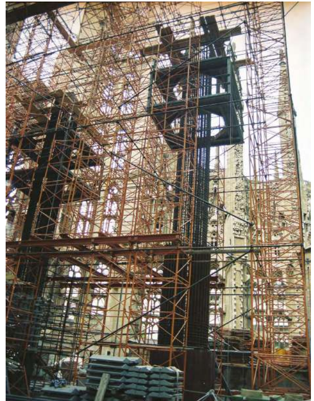
Fig. 5: La construcción de las columnas interiores se completó por dentro de las fachadas existentes entre 1991 y 2003 (© Fundació Junta Constructora del Temple de la Sagrada Família)
