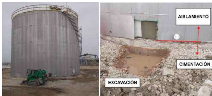
Fig. 2 Vista general y acercamiento de la base deteriorada del tanque de almacenamiento (Fig. 5.1 en la Referencia 3)
