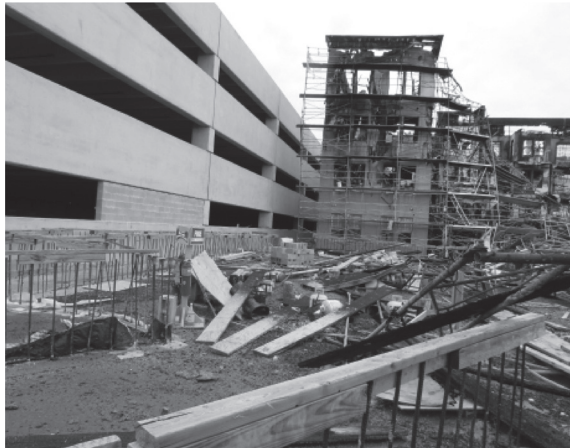
図 - 1 集合住宅部の被災状況
