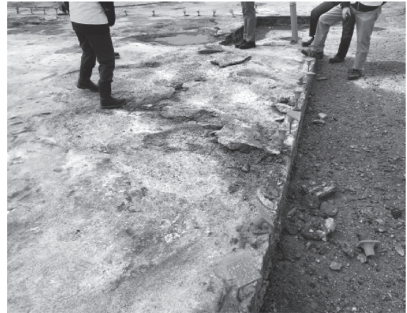
図 - 3 ポディウムスラブ部表面の被災状況
