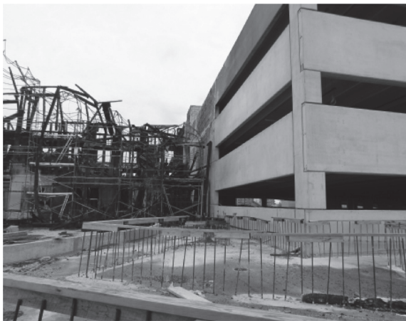
図 - 2 集合住宅部の木造の被災状況（別アングル）
