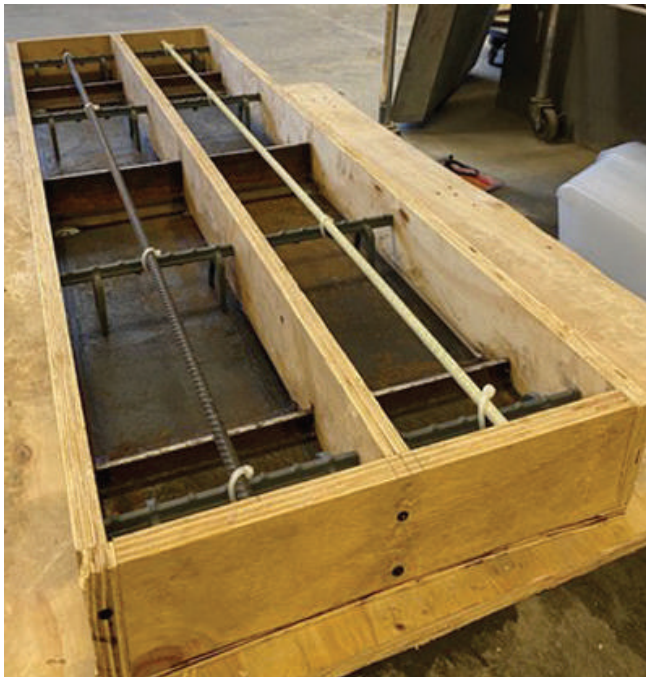
Fig. 6: Encofrado, barras de refuerzo e iniciador de grietas para la preparación de la muestra de ensayo de agrietamiento por contracción
