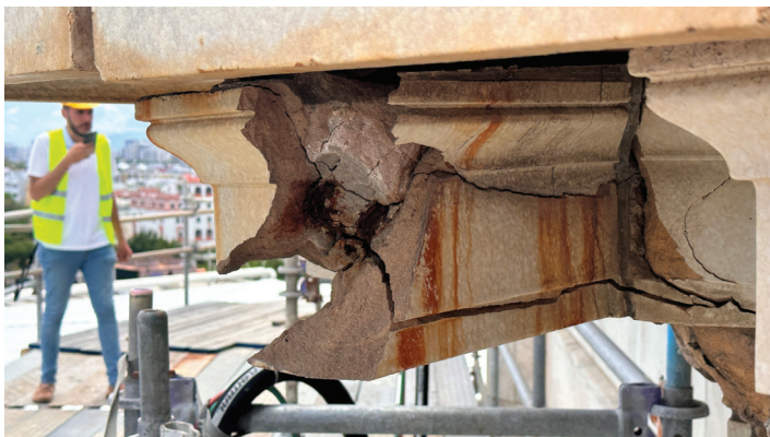
Piezas ornamentales de terracota en la base del domo mostrando los daños por corrosión y agrietamiento.
