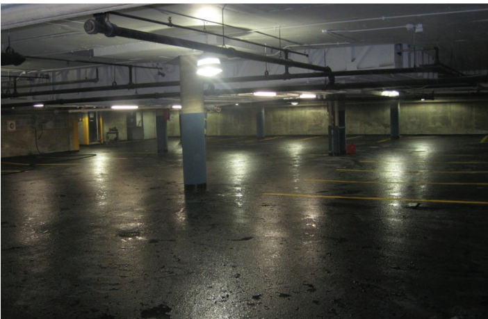
Fig. 4: Una estructura de estacionamiento subterráneo con impermeabilización.
