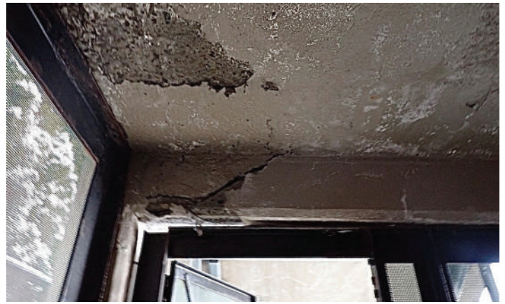
Fig. 4: Esta amplia grieta diagonal cerca de un soporte indica la necesidad de apuntalamiento e investigación adicional.
