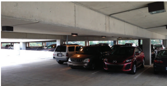
Fig. 2: Una viga dentro de la estructura de un estacionamiento: (a) una vista general; y (b) una vista en primer plano de una grieta en la cara de la viga y la losa.
