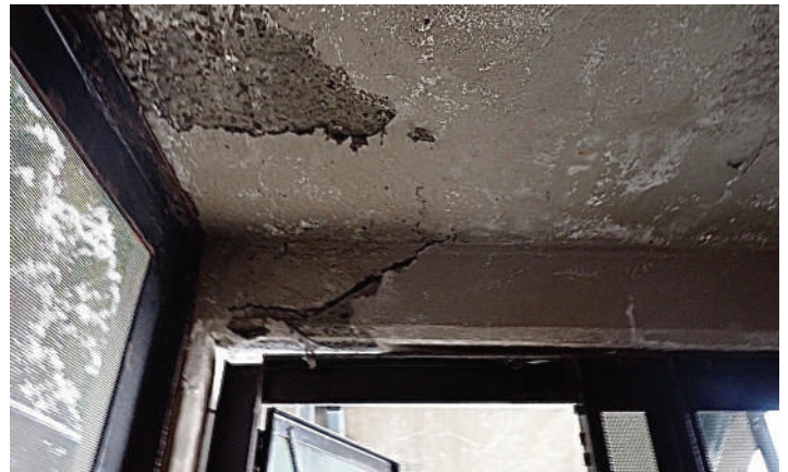
Fig. 5: Barras de refuerzo corroídas en un balcón (en reparación).
