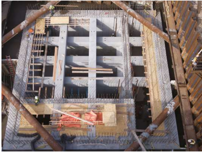
Estación de Bombeo Principal Argentina.
