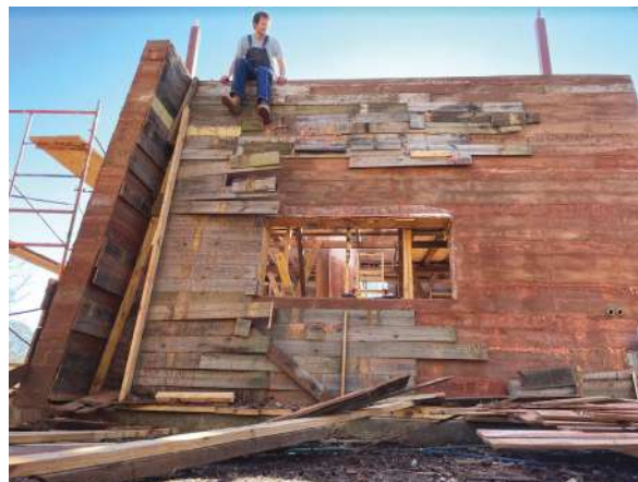
Fig. 3: Los muros de concreto se texturizaron utilizando tablas rescatadas de un granero.
