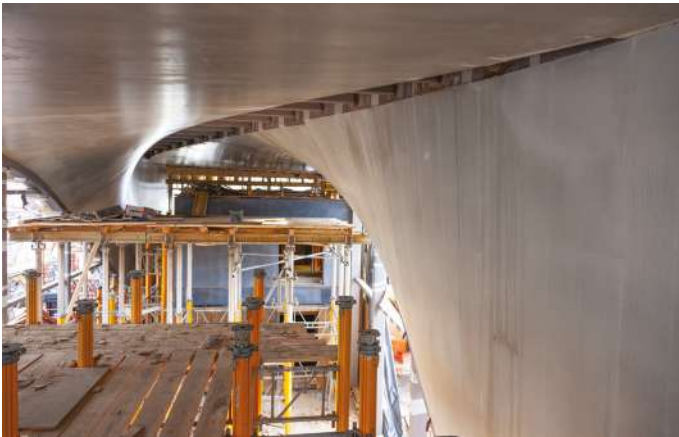
Figura 3: La parte curva del Sistema de muro fue construida usando un encofrado de fabrica llevado al lugar (foto cortesía de Stefan Groeschel, IMB, TU Dresden)
