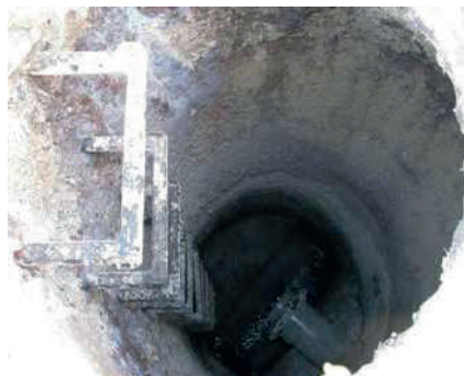
Fig. 2: El sulfato de calcio (yeso) forma una masa espumosa blanquecina sobre el concreto
